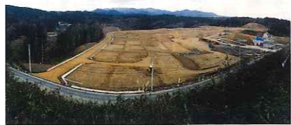
上/小泉地区集団移転の計画図(2014年7月31日作成) 下/小泉地区の造成工事の様子(2014年11月16日撮影)
